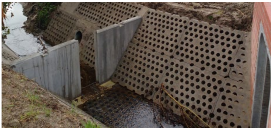
Dankzij een knijpstuw in de beek zal het spaarvolume in de put sneller terug worden aangevuld.
