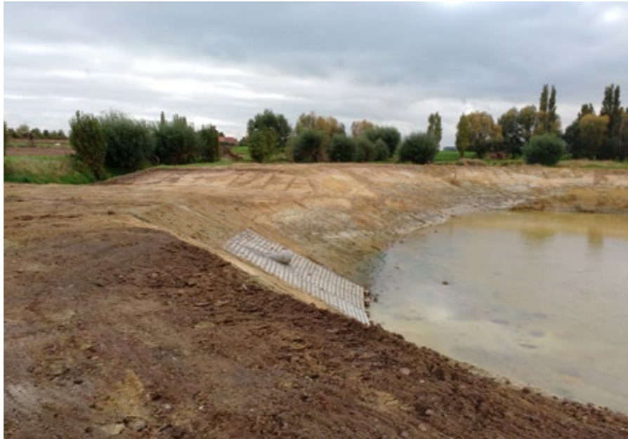
Buis én overloopzone bij een concreet pps project
